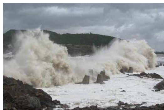
Hình 2b: Đê chắn sóng Hòn Cỏ - Hòn La bị sóng bão năm 2012 gây hư hại nặng Nguồn: Báo Nông nghiệp Việt Nam
