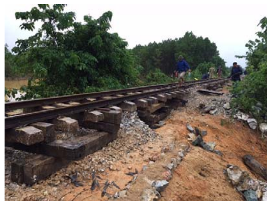
Hình 3b: Đường sắt đoạn qua Quảng Bình, xói lở do mưa lũ 2016 Nguồn: Báo Lao động
